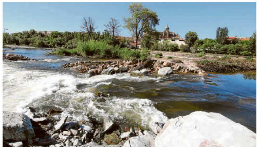
Tramo de la pesquera que se vino abajo, por donde aún sigue fluyendo el agua del Tormes. | ALMEIDA
