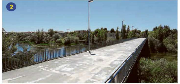
La deteriorada pasarela situada junto a la depuradora de Tejares. Peatones y ciclistas utilizan la pasarela que contiene la tubería de impulsión de aguas residuales de la margen izquierda para llegar desde Tejares hasta el sector de El Marín. Su pavimento está muy deteriorado y su iluminación deficiente. El Consistorio invertirá en ella 100.000 euros.
