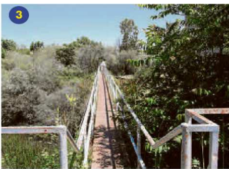
Una pasarela inaccesible. Con escalones a sus dos lados, la antigua pasarela del barrio de Tejares ni siquiera tiene un metro de ancho, por lo que no resulta accesible para los peatones, pero mucho menos aún para las bicicletas.
